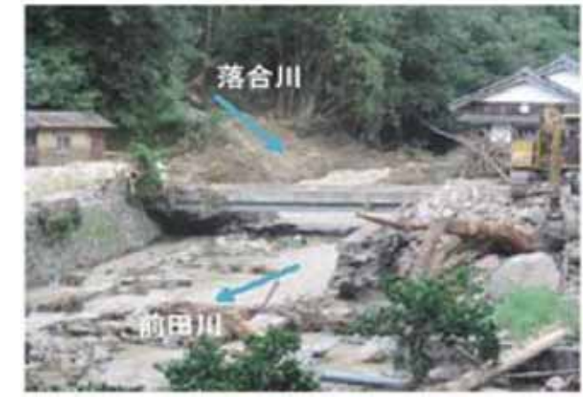
大野原町五郷地区の被災状況 3 平成 16 年 8 月 20 日 18 時 撮影
