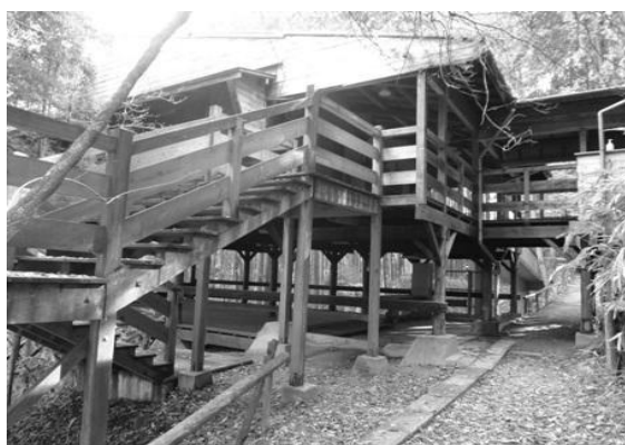
大型ロッジ（老朽化が進んでいる）
