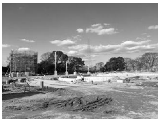
工事中のファミリープール。ウォータースライダーの支柱と流れるプールが見える
