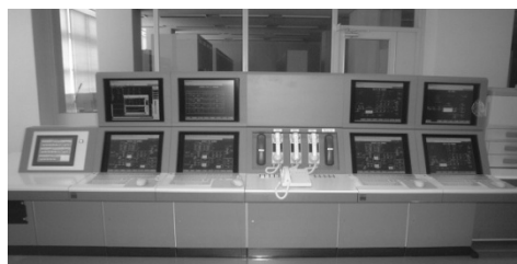
中央監視制御システム
