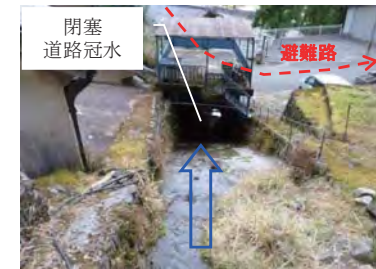
五百瀬②集落からの避難路には、大雨時に閉塞して冠水の危険性が高い地点がある。
