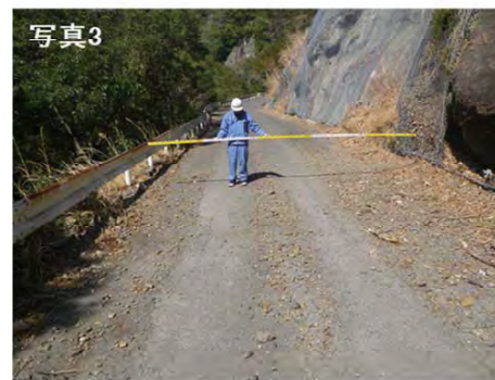
避難路の安全性 落石が頻繁に発生する地点
