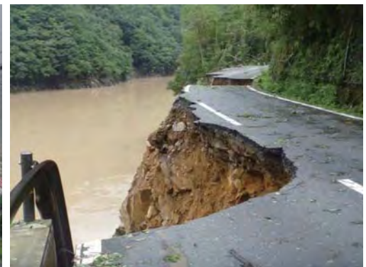
道路崩落による国道の寸断 (十津川村桑畑地区)
